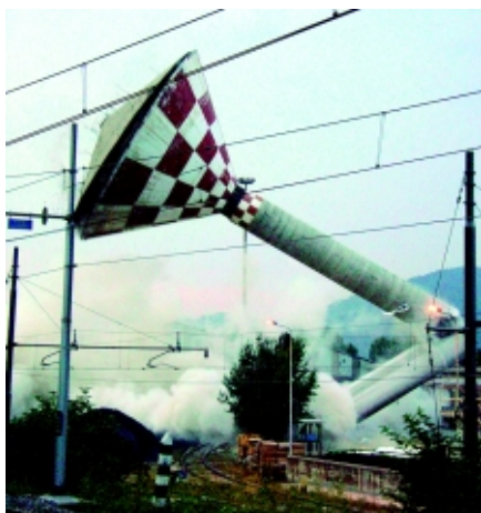
Piezometro di Lesegno: nel cortile dello stabilimento a un passo dai binari
